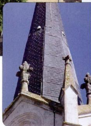
Antenne installée dans un clocher derrière les ardoises synthétiques.
