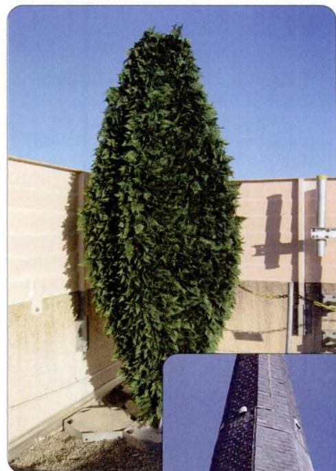
Habillage d'une antenne avec de la végétation synthétique.
