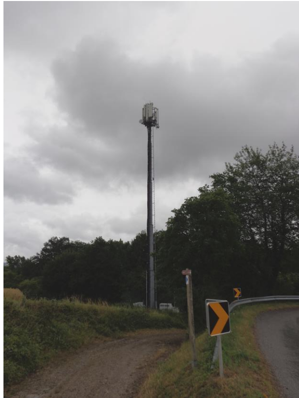
Figure 2 : Photo des antennes
