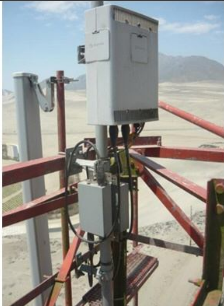
Figura 4.2 RRU & Filtros en pole
