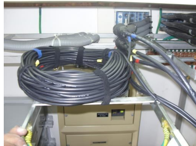
Excedente en escalerilla interna
